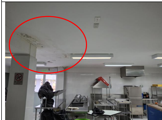
ฝ้าเพดานเสียหายจากน้ำรั่วซึม
